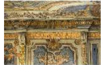
BayO.II, Trocknungsrisse am Blindrang, DI029084, BSV-
